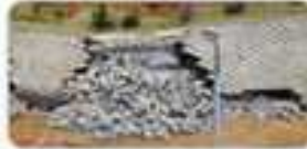
시설 파손(옹벽 붕괴, 포트홀 등)
