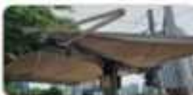
시설 파손(그늘막 등)
