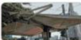
시설 파손(그늘막 등)
