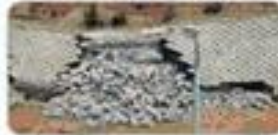
시설 파손(옹벽 붕괴, 포트홀 등)
