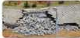
시설 파손(옹벽 붕괴, 포트홀 등)
