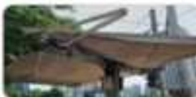
시설 파손(그늘막 등)
