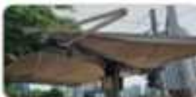
시설 파손(그늘막 등)
