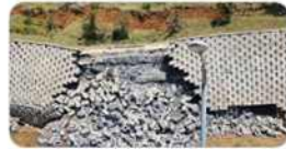
붕괴 위험(옹벽, 축대 등)
