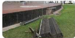
축제장 시설 파손
