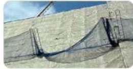
낙하물 방지망 파손
