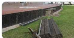
축제장 시설 파손
