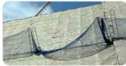
낙하물 방지망 파손
