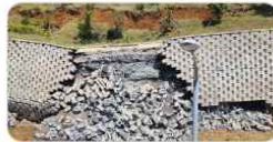
붕괴 위험(옹벽, 축대 등)
